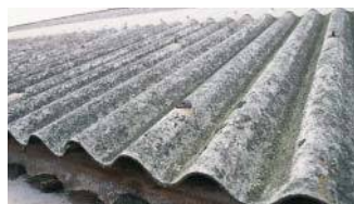
Toiture en amiante-ciment
